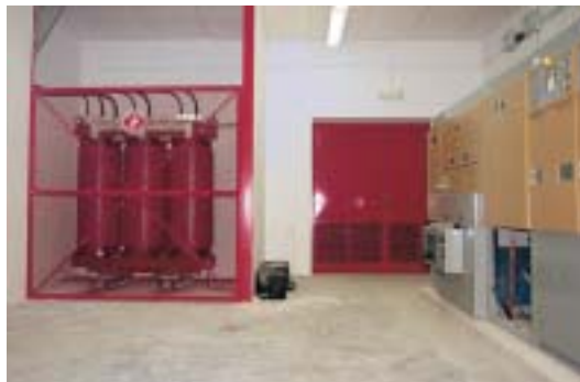
Transformator Trihal (IPO0) zainstalowany na wystawie światowej EXPO 92 w Sewilli.
