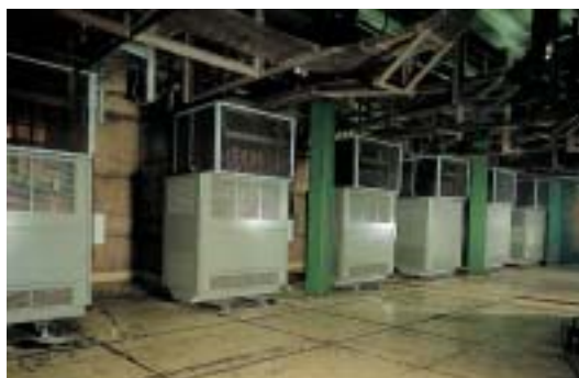
Transformatory Trihal w obudowach metalowych IP 31 zainstalowane w hucie stali.
