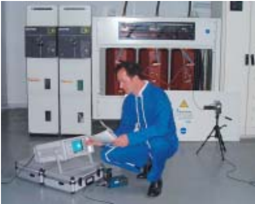
Sprawdzenie przed uruchomieniem
